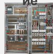
Щитовое оборудован ие
