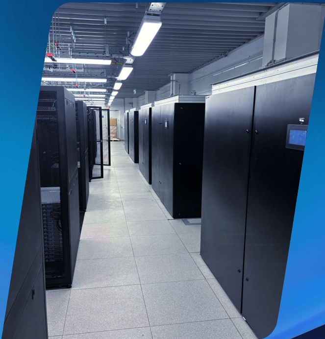
120 кВт каждый кондиционер. Объект – 1,2 МВт (10 шт)
