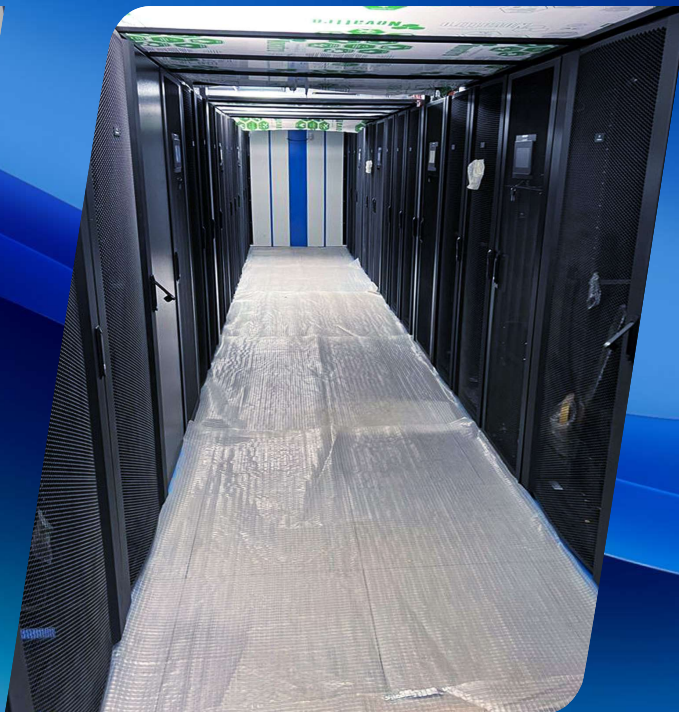
50 кВт каждый кондиционер. Объект – 400 кВт. (8 шт)
