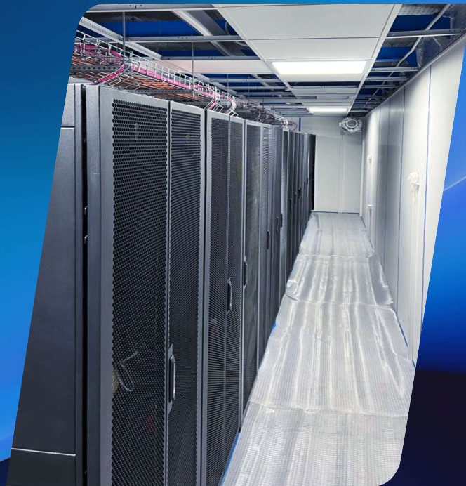
40 кВт каждый кондиционер. Объект – 560 кВт. (14 шт)
