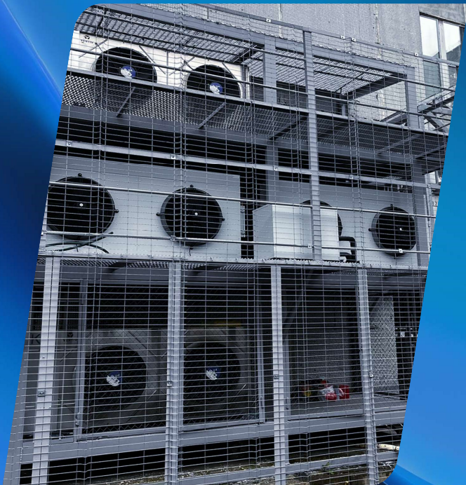
50 кВт каждый кондиционер. Объект – 300 кВт (6 шт)
