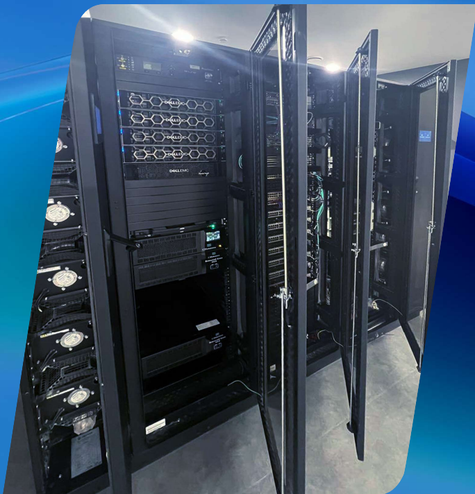
25 кВт каждый Объект – 50 кВт (2 шт)
