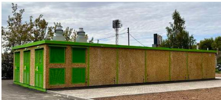
КОМПЛЕКТНАЯ ВЫСОКОАВТОМАТИЗИРОВАННАЯ РАСПРЕДЕЛИТЕЛЬНО-ТРАНСФОРМАТОРНАЯ ПОДСТАНЦИЯ
