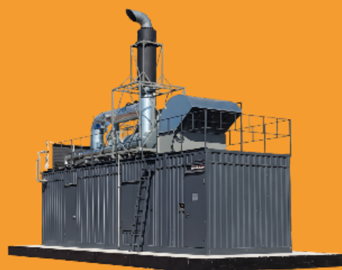
ГПЭС (основной источник)
